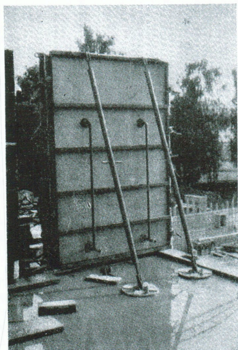
Fig. 4. Een stel vacuumbekistingsplaten met vacuümsteunen, waarmede in een hoog flatgebouw 105 vacuümbetonwanden ter plaatse werden gemaakt.
